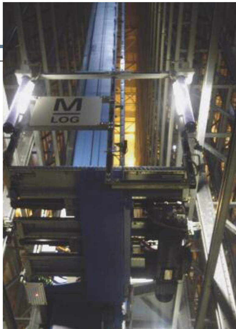
ALCUNI PARTICOLARI DEL SISTEMA AUTOMATICO SERVITO MEDIANTE 4 TRASLOELEVATORI
